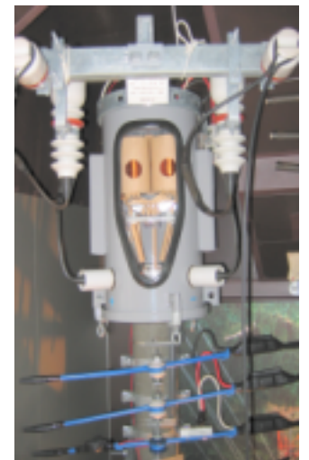
柱上トランス ↑
